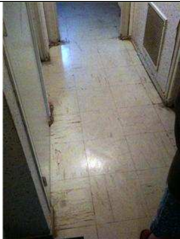
001 - Appartements - Entrée LOT 0002 PH37 : Dalles de sol non amiantées Sur colle noire et ragréage amiantés PRE038
